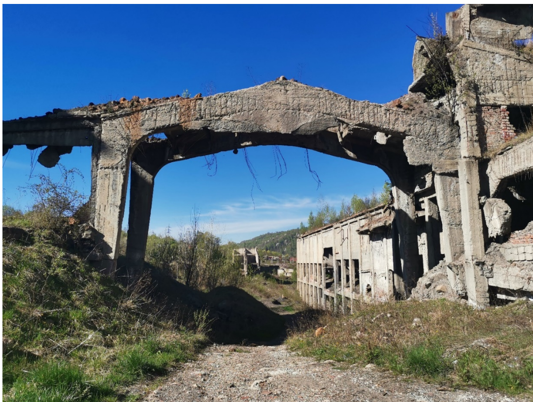
Fig. 1. Construcții aflate în stare avansată de degradare, cu risc de prăbușire
